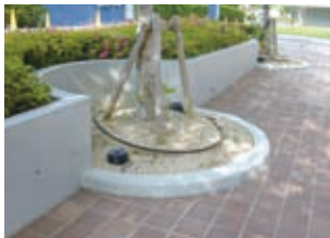
雨水散水設備
