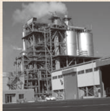
川崎バイオマス発電
