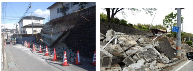
(a) 仙台 (b) 熊本 写真1 擁壁被害の様子 1),2)
