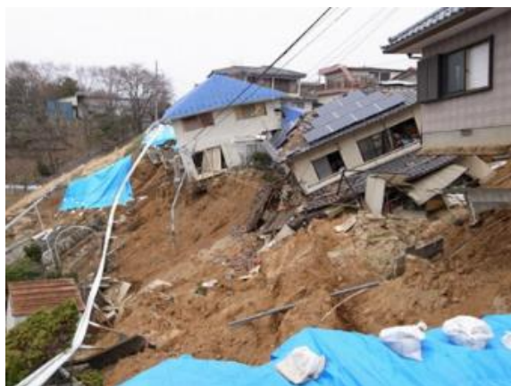
写真-1 造成地での被害状況 1)
