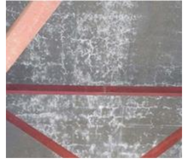
写真7 床版底面のひび割れ 2)
