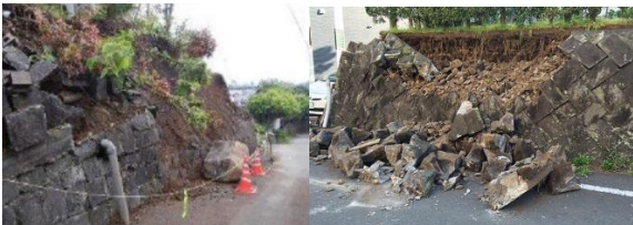
写真1 地震による擁壁被害 1)
