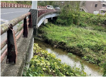
写真1 一部が埋没した橋梁(妻木川)
