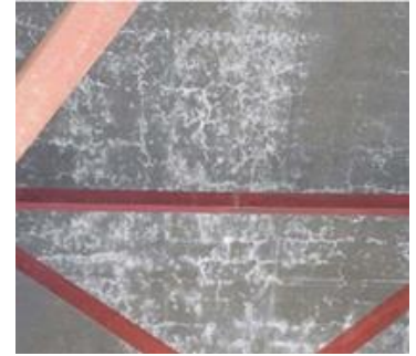
写真7 床版底面のひび割れ 2)
