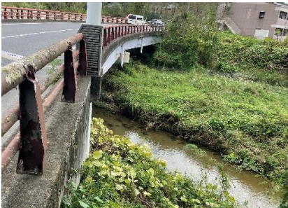
写真1 一部が埋没した橋梁(妻木川)
