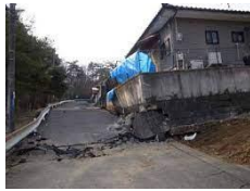
写真-2 住宅被害 (仙台市)
