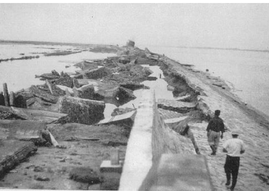
決壊した海岸堤防(半田武豊)
